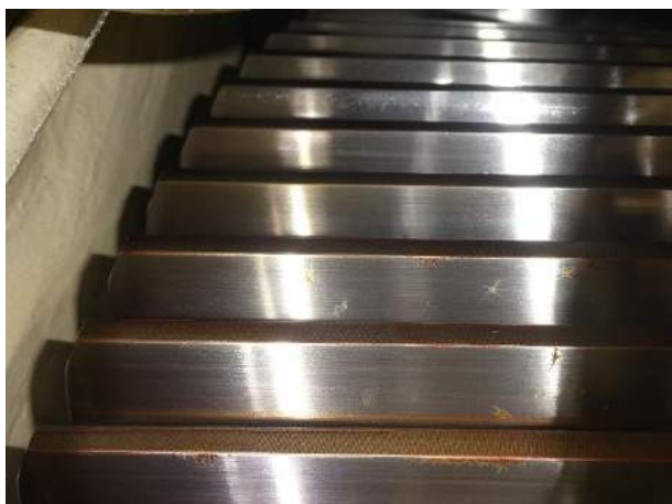
Rad langsame Welle, Lastflanken i.O.
