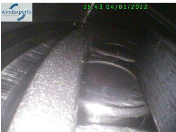
HSS Welle, Lager Rotorseite nur sehr bedingt einsehbar, keine Auffälligkeiten.
