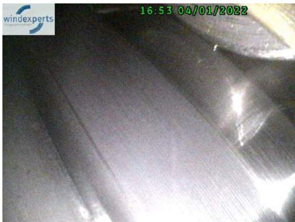
LSS Welle, Lager Generatorseite nur sehr bedingt einsehbar, unauffällig.
